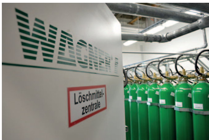
Die Brandlöschanlage im Senckenberg Museum in Frankfurt basiert auf einer FirExting®-Gaslöschanlage mit Argon. © WAGNER Group GmbH
